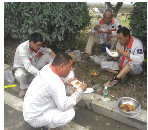
6月28日,在地面温度达40多度的中午时间,位于池月路富佳搅拌站的环网柜旁,满头大汗的供电公司台北供电所员工顾不上休息,正盘坐在树荫下吃着快餐,与接下来的抢修工作争抢时间。进入夏季供电高峰时期,工投供电人想客户所想、急客户所急,全力以赴保供电,赢得了客户的信赖。(钱明华)
